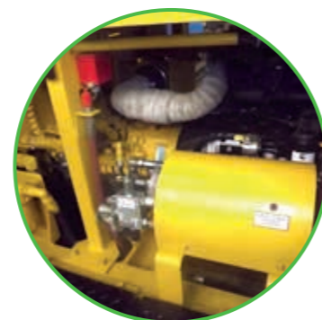
Dodatkowy alternator ładowania akumulatorów zasilających wentylator nawiewowy
