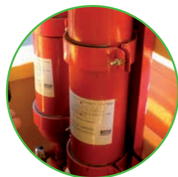
Stała instalacja gaśnicza
